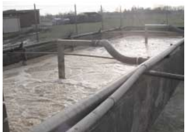
Abb. 3: Hauptklärbecken der biologischen Stufe
